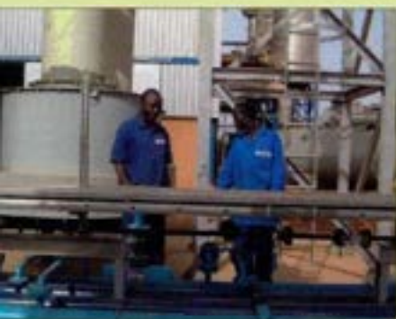
Det nye kraftanlæg er lille efter danske forhold, men stort i Burkina Faso. Fotos: Erik Moe
